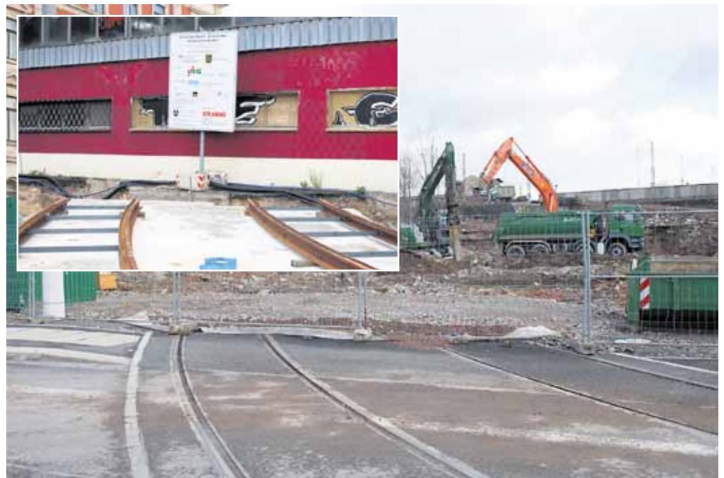
Straße der Nationen: Sah es im Herbst 2011 noch so aus, als ob bei der Planung etwas schief gegangen ist, sieht man jetzt, wohin die Gleise weitergeführt werden. Der sogenannte CubeClub (ehemaliger Speisesaal der Post) wurde Stück für Stück abgetragen.
